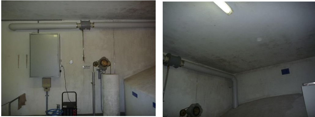
Abb. 4: Be-/Entlüftung Wasserkammer mit Filtergehäuse (Fotos 18.05.2022)
