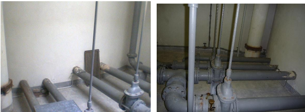
Abb. 5: Best. Grossrohrinstallation (Foto links 13.02.2009, Foto rechts 18.05.2022)
